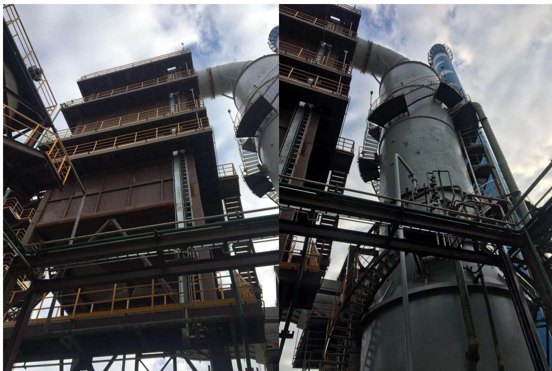
图 4.1—6 废气治理装置图（左：湿电除尘 右：脱硫塔）
