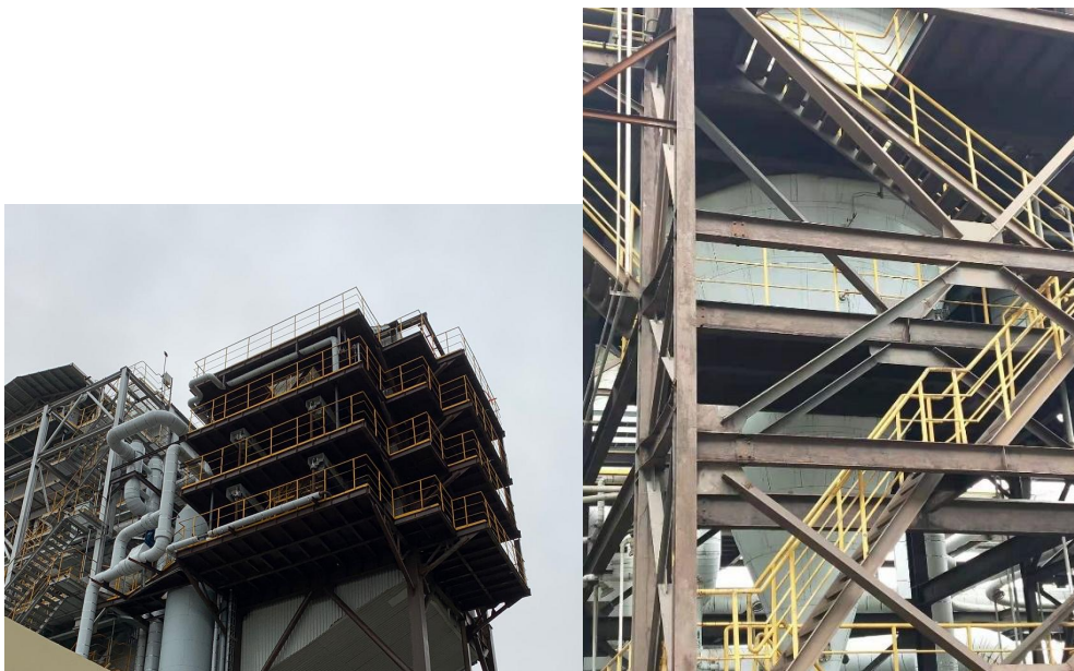
图 4.1-8 废气治理装置图（左：脱硝装置；右：燃烧炉布袋除尘器）
