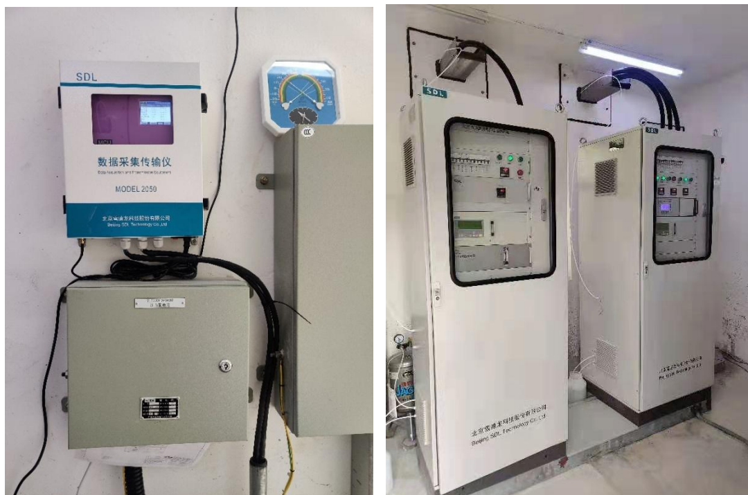
图 4.2-4 尾气锅炉排气筒在线监测系统装置
