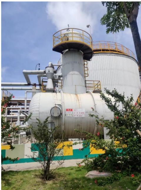
图 4.1-7 废气治理装置图（左：洗油塔）
