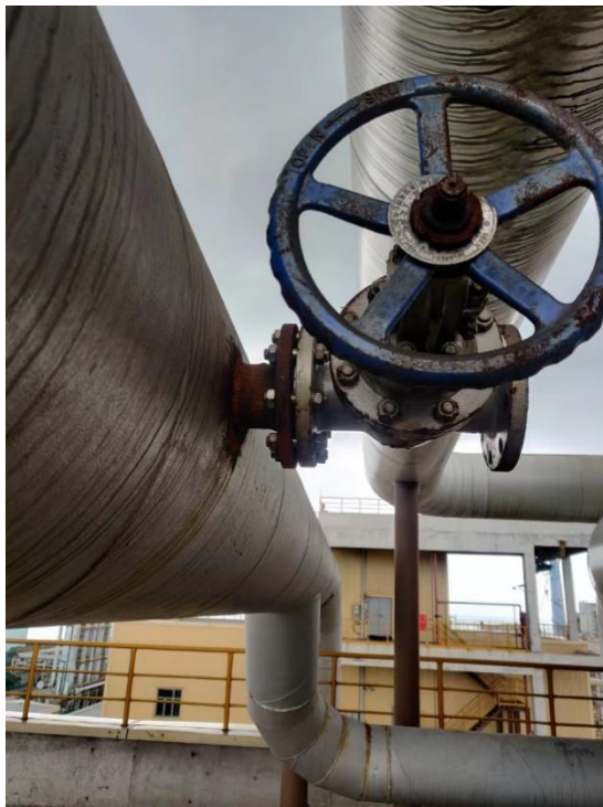
图 4.2-3 部分采样设施（炭黑尘排口采样孔）
