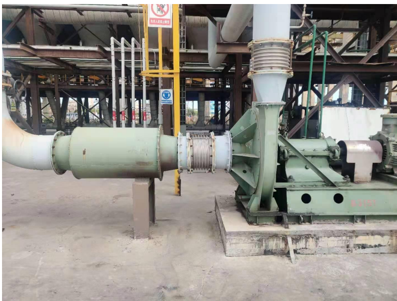
图 4.1-14 噪声防治措施（除尘风机出口消声器）
