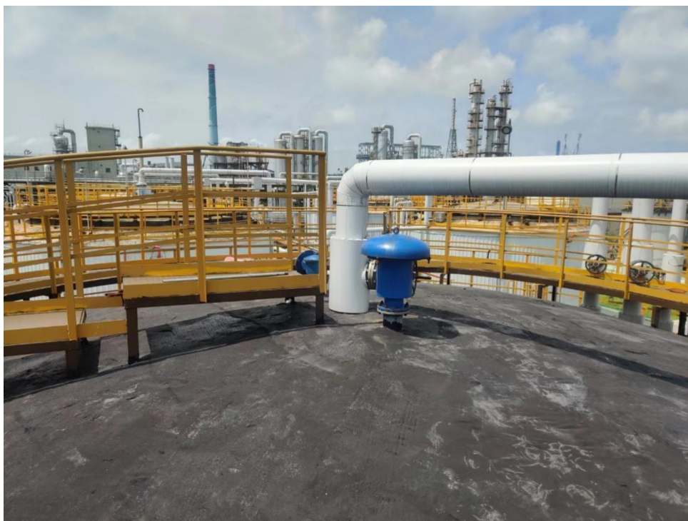
图 4.1-11 槽体呼吸废气无组织控制措施
